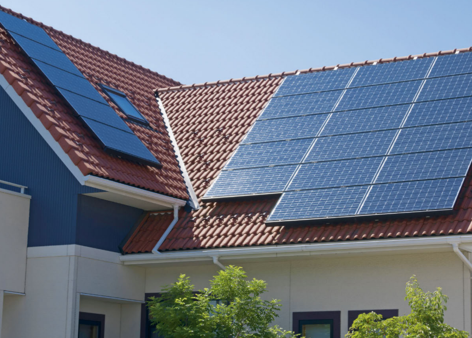
Photovoltaik Der Strom vom eigenen Dach lässt sich auch für die eigene Wärmepumpe nutzen.
