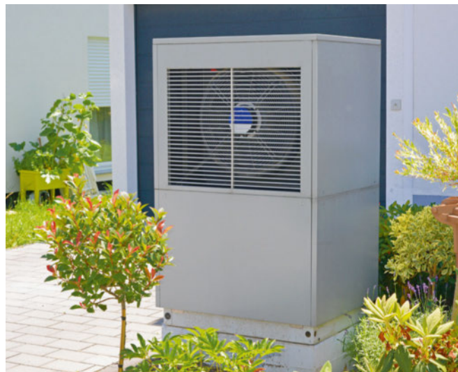
Umweltwärme Mit einer Wärmepumpe wird zum Beispiel die Wärme aus der Luft genutzt.
