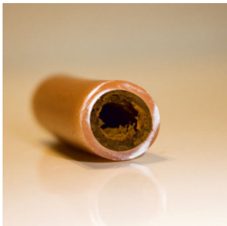
Versprödetes und verschlammtes Bodenheizungsrohr.
